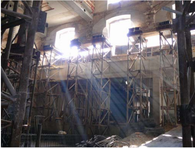
Pohled zvnitřku objektu na podchycenou průčelní fasádu v době budování nových základů (asi o rok později než předchozí obrázek).
