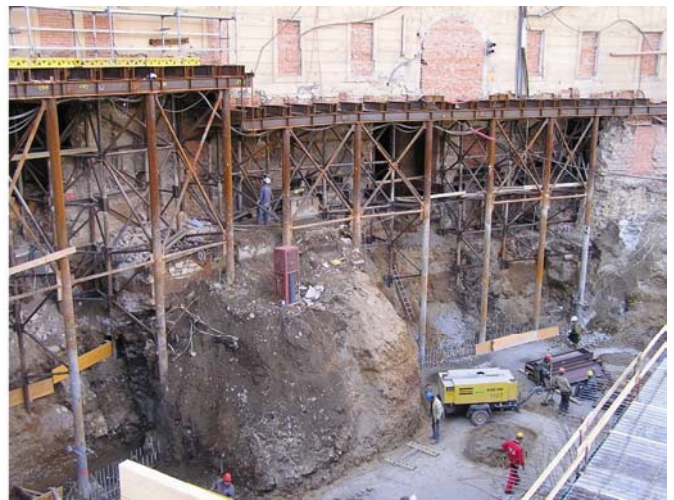
Podchycení průčelní dvorní stěny v jižním křídle a ve střední části budovy kasáren. Pod patou ocelových sloupů se nachází podzemní stěna. Kompresor stojí na podkladním betonu pro stropní desku Hlavní budovy, ze které probíhala výstavba metodou top&down.
