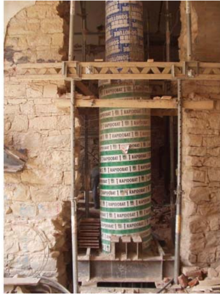
Zhotovení nového železobetonového sloupu ve svislé drážce v původním zdivu a jeho dočasné založení na mikropilotové báře v úrovni 1.NP.
